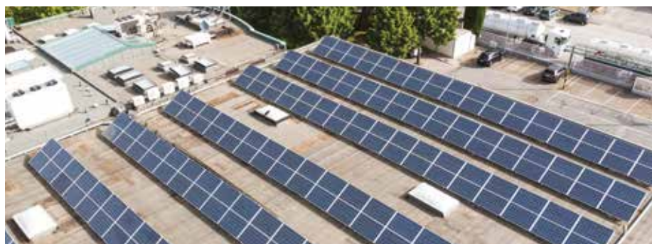
Impianto fotovoltaico Olitalia
