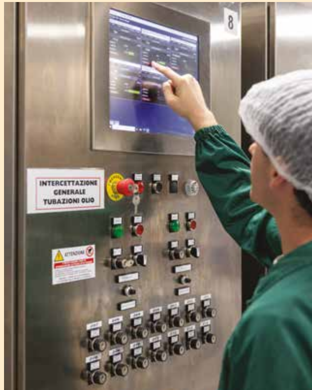
Sistema integrato di gestione e controllo dello scarico, dello stoccaggio e della movimentazione dell'olio sfuso
