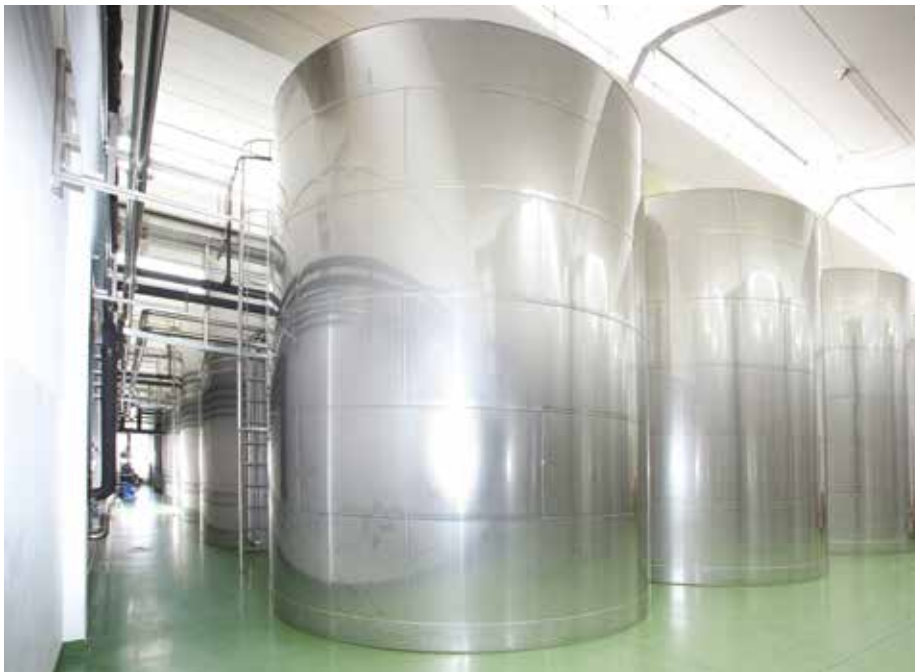
Magazzino B: cisterne coibentate
